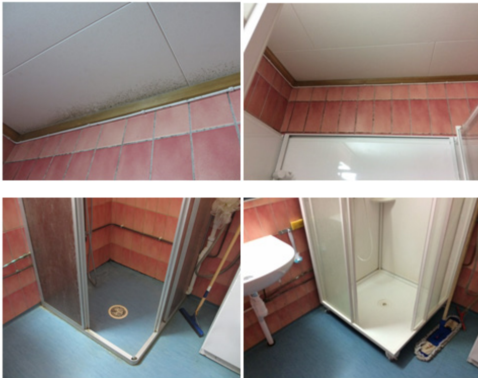
Figur 7: Før og etter-bilder fra desentralisert bolig. Bildene til venstre viser badet slik det så ut ved første tilsyn. Manglende mekanisk avtrekk og påfølgende fuktproblematikk har medført synlige tegn til vekst av mugg på overflater. Bildene til høyre er tatt under et oppfølgingstilsyn, hvor virksomheten blant annet har sørget for mekanisk avtrekksventilasjon, gjennomført overflatebehandling og satt inn et dusjkabinett siden forrige tilsyn.
